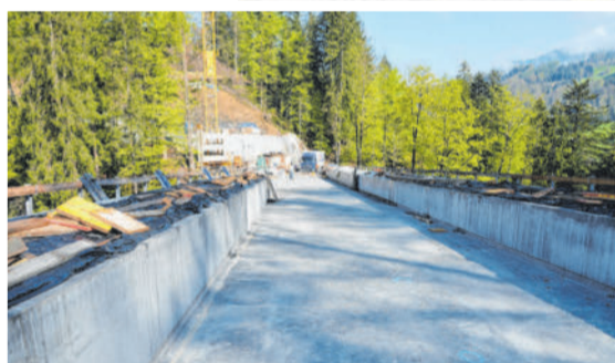
Die Fahrbahn muss noch gemacht werden, dann gibt es wieder eine kurze Verbindung ins Ebnit.
